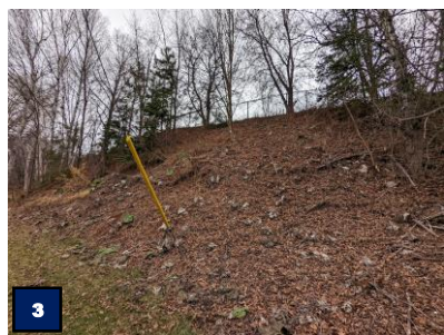
Secteur avec érosion sur la pente (et présence de déchets)
