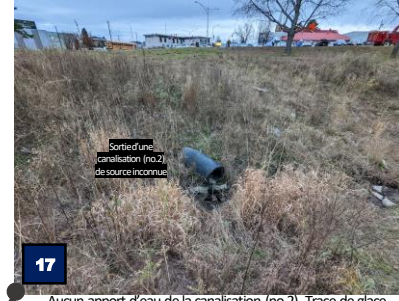
Aucun apport d'eau de la canalisation (no.2). Trace de glace.
