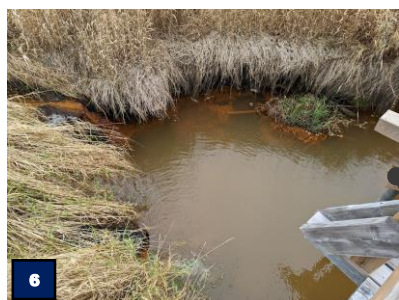
Érosion à la sortie des canalisations
